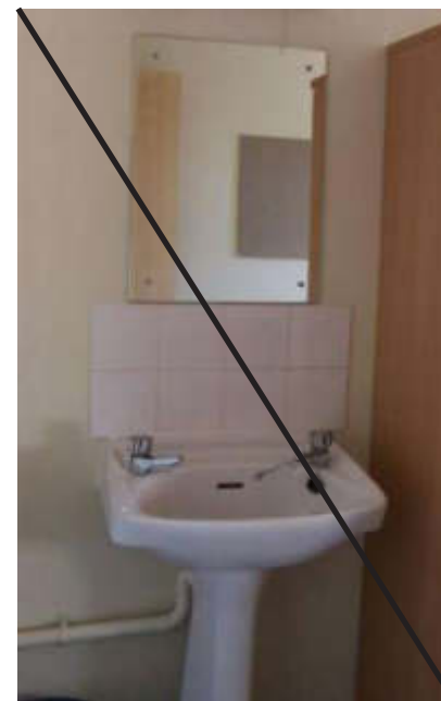
Плохо Раковина с пьедесталом. Фартук из плитки
