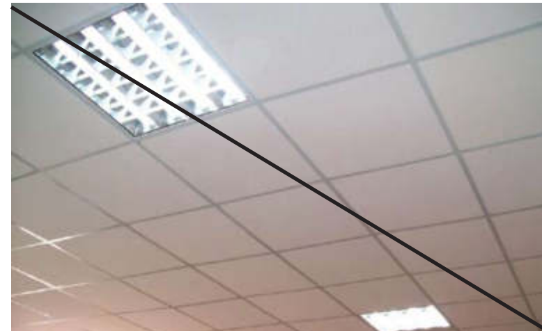
Плохо Открытые направляющие
