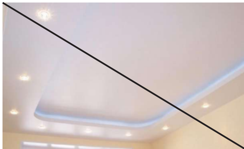
Плохо Многоуровневые гипсокартонные конструкции
