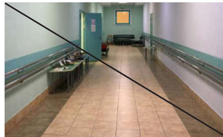
Плохо Керамогранитная плитка с крупными швами
